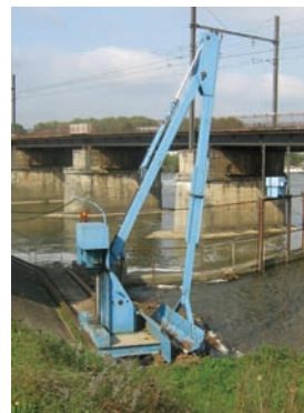
Photographie 33 : Dégrilleur automatique (GEI/SIEE)
