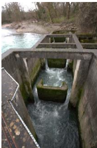
Passe à doubles fentes verticales (@ pôle écohydraulique, OFB)
