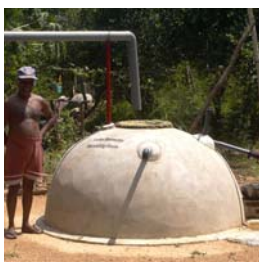
Figure 47 : Cuve semi-enterrée (dome tank) (source : T. Thomas)
